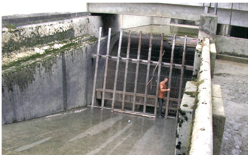
Bild 5 Wasserkraftanlage am Mühlbach in Landsberg am Lech, Segmentbogen-Rechenreinigungsanlage mit vorgeschaltetem Grobrechen.
