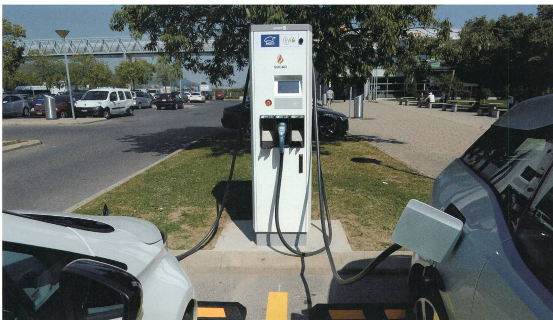
La borne de recharge de l'aire d'autoroute du Relais de la Côte (A1) sur la commune de Bursins.
