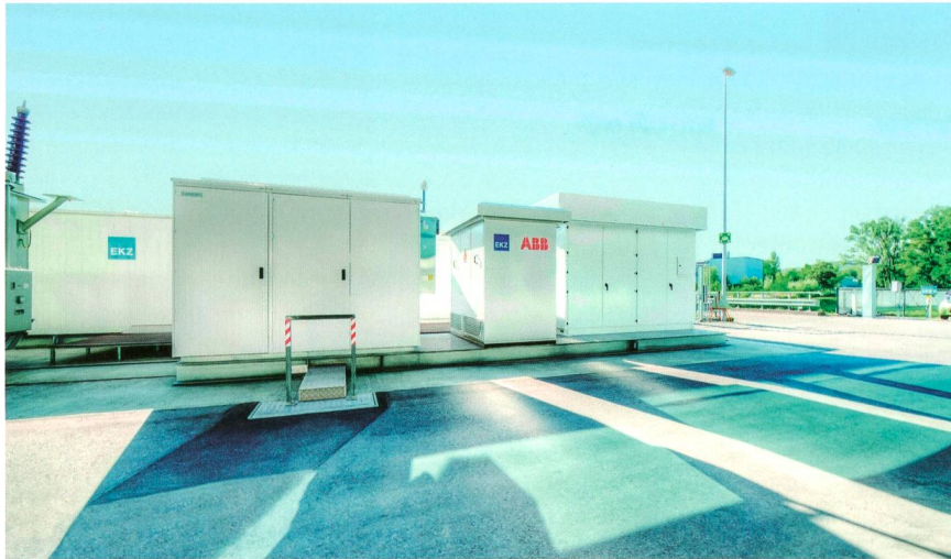
Bild 2 Batteriespeicher der EKZ zum Betrieb eines Bürogebäudes als Microgrid.
