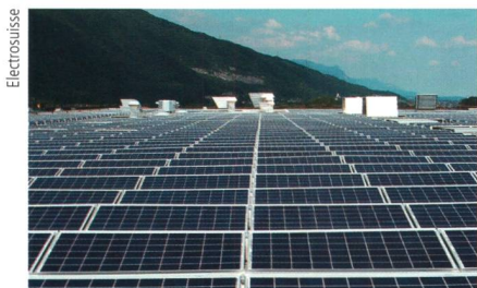
PV-Anlage auf dem Dach der Tissot Arena.
