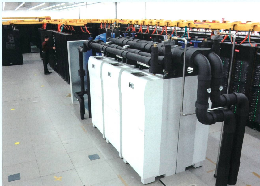
Der Coolmuc-2-Rechencluster (links) liefert die Antriebswärme für sechs Adsorptionskältemaschinen im Leibniz-Rechenzentrum.
