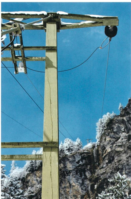
Bild 2 Das Stromnetz muss grosse Höhenunterschiede überwinden. Der höchste Netzpunkt auf dem Schilthorn liegt auf 3000 Metern über Meer.
