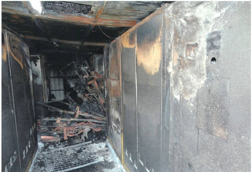
Bild 5 Durch Brand zerstörter elektrischer Betriebsraum mit Wechselrichter und Schaltgerätekombinationen.
