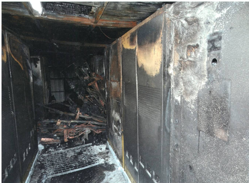
Figura 5 Locale di esercizio adibito a servizi elettrici con inverter ed apparecchiature assiemate di manovra distrutto da un incendio.
