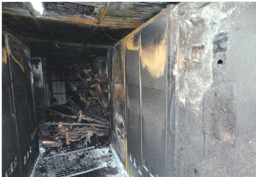
Figure 5 Local électrique contenant des onduleurs et divers appareillages de commutation détruit par un incendie.
