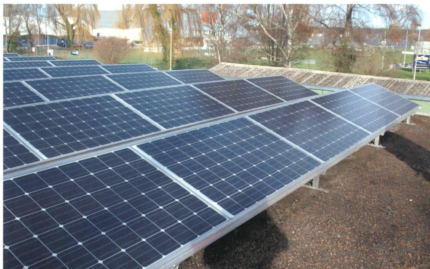
Figura 1 Non appena splende il sole, i pannelli solari sono sotto tensione.
