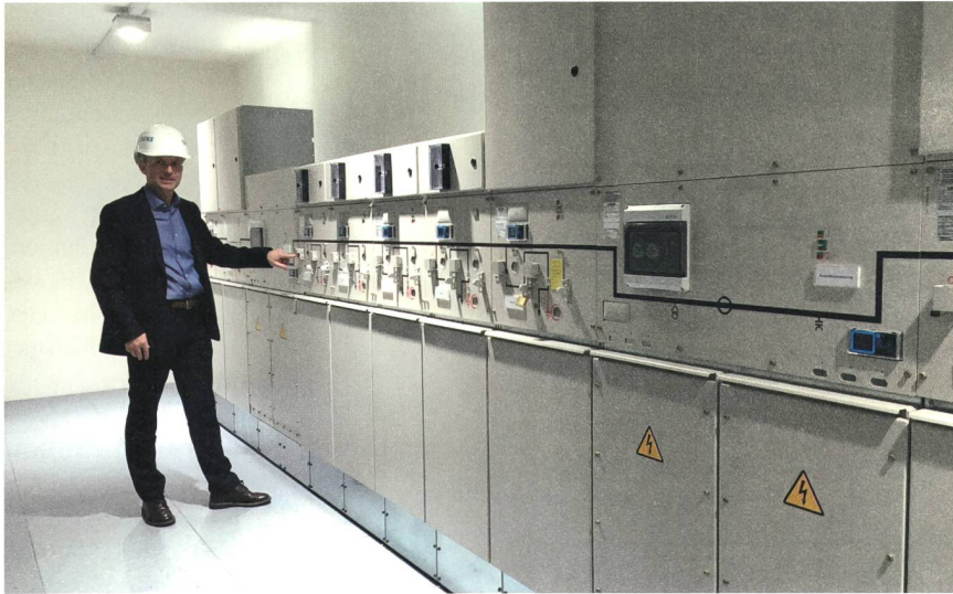
Bild 2 CKW setzt auf intelligente Ortsnetzstationen von Siemens.
