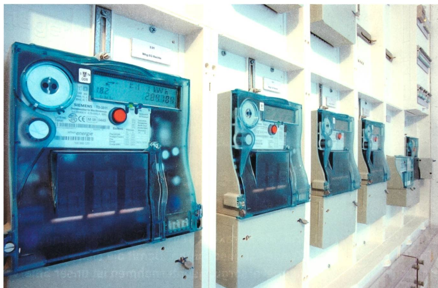
Figure 1 Les compteurs électriques de la dernière génération (smart meter) saisissent la consommation électrique toutes les 15 minutes. Les mesures permettent de tirer des conclusions sur le foyer correspondant.
