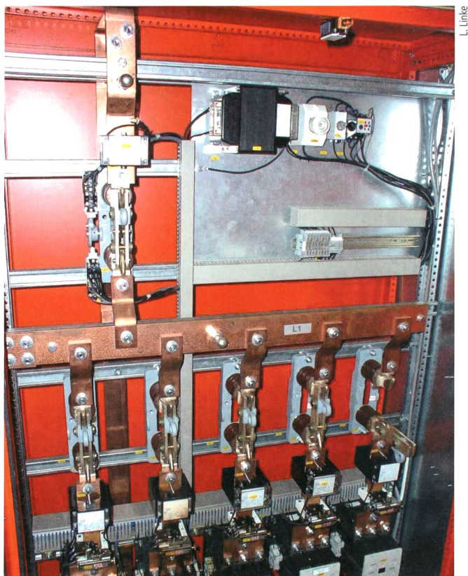
Bild 2 Sammelschiene 1 AC 1 kV 16,7 Hz DB-Zugheizstation.
