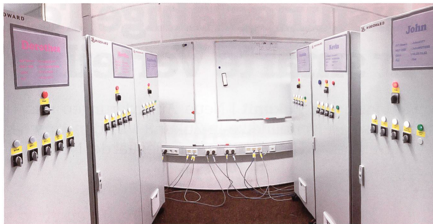
Bild 3 Hardware-in-the-Loop-Testlabor in der Woodward Kempen GmbH für unabhängiges (automatisiertes) Testen von Wandler-, Generator- und Netzkonfigurationen.
