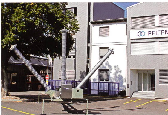
Eine Mobile Messstation, 3-Phasen RC-Teiler.
