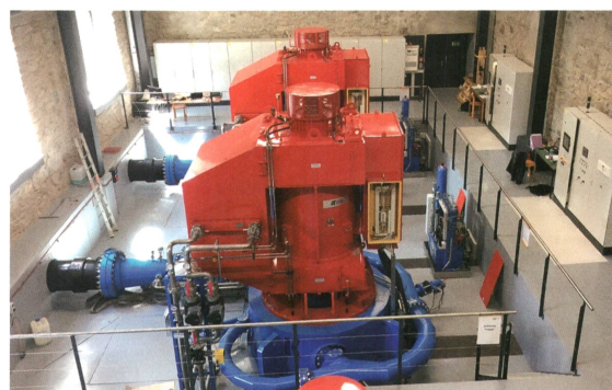
Die erneuerte Kraftwerkszentrale in Gurtellen mit den vertikalen Turbinen.
