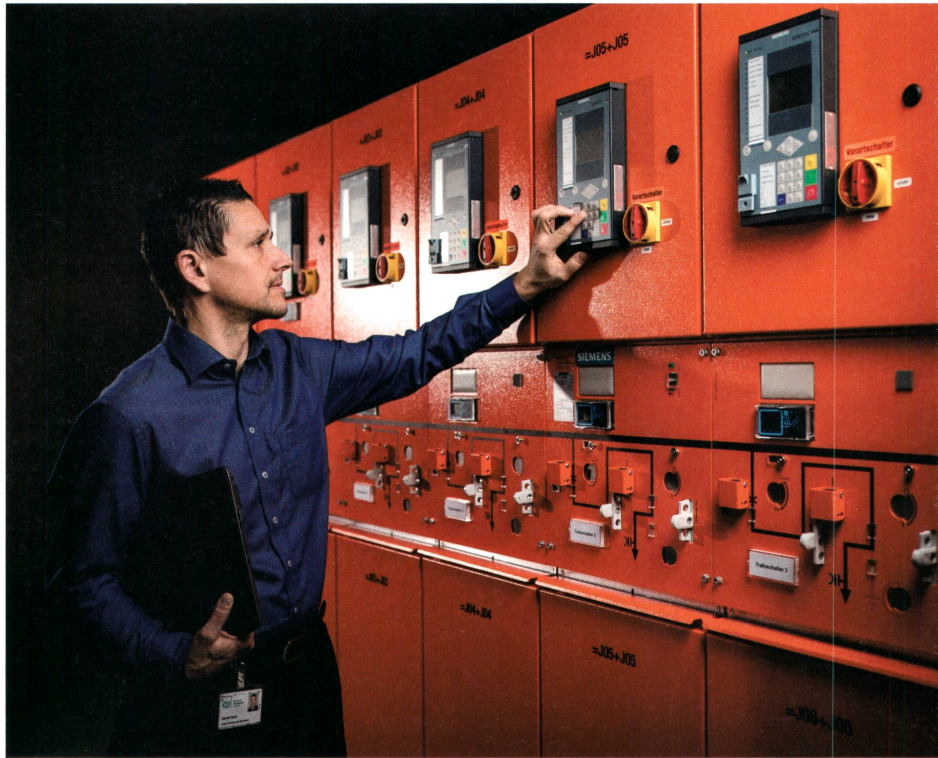
Daniel Hauri, Leiter Technik und Sicherheit des SPZ, prüft die Mittelspannungsanlage von der Siemens, Typ 8DJH.
