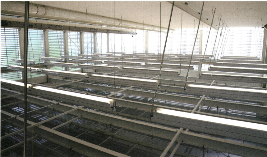
Das «Davoser Kaltdach» des Kirchner-Museums leitet das Tageslicht in die Ausstellungsräume. Die Fluoreszenzröhren unterstützen das Tageslicht bei Bedarf. Mit den Lamellen lässt sich das Tageslicht «dimmen».
