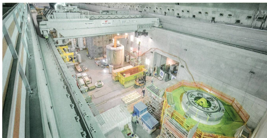
Figure 2 La caverne des machines contient six pompes-turbines de dernière génération de 150 MW chacune.
