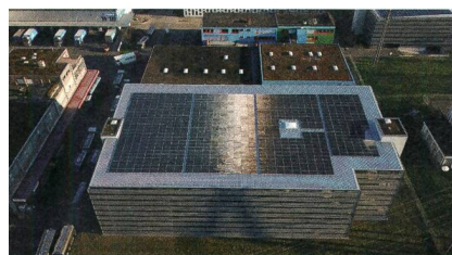
Die Module auf Parkhaus 3.
