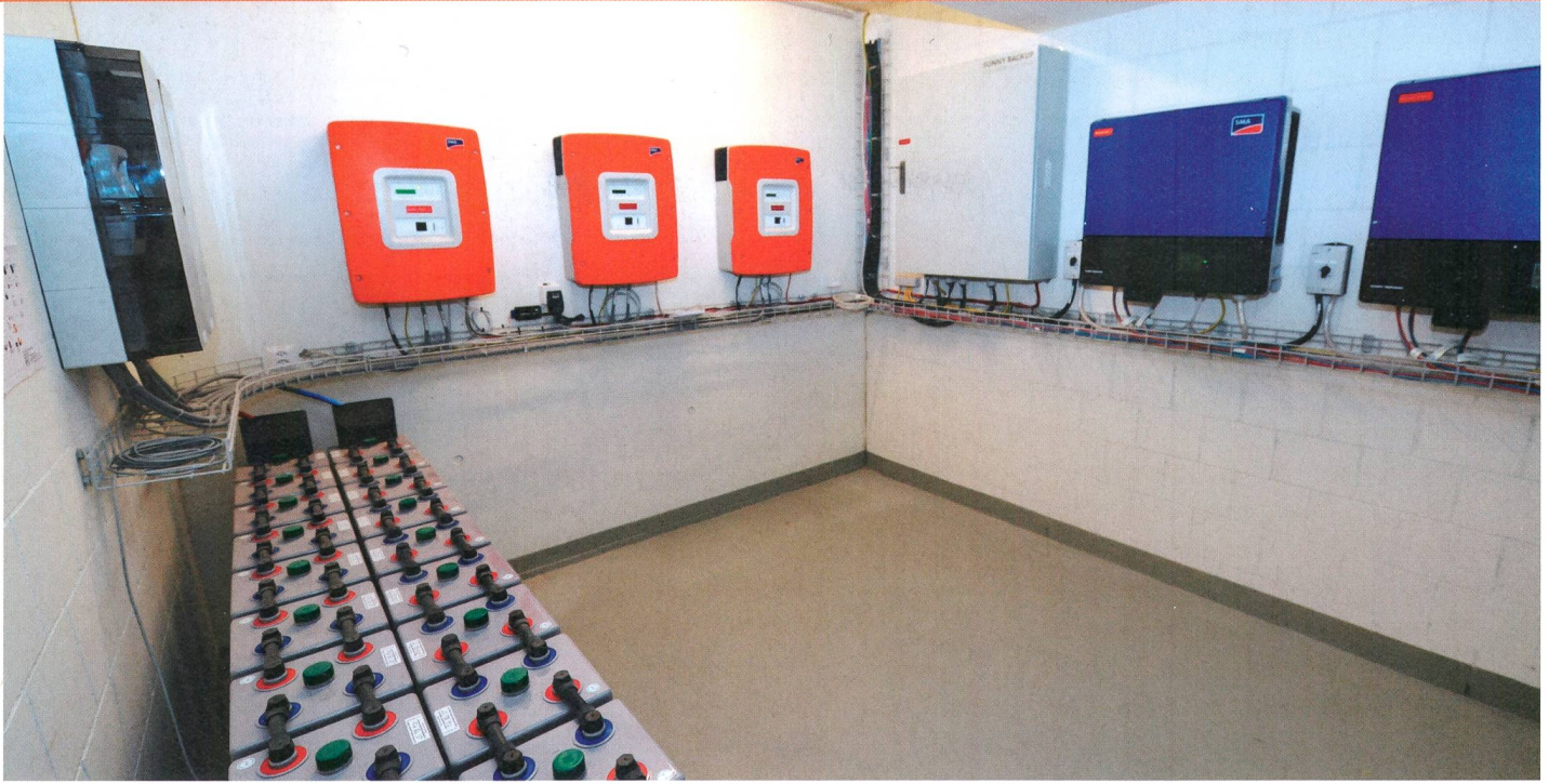
Batteries, redresseurs et onduleurs.
