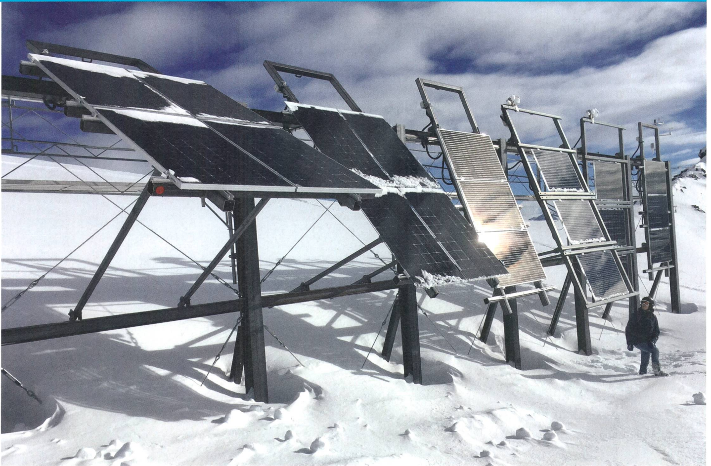
Installation photovoltaïque réalisée pour des essais à 2500 m d'altitude, sur le domaine skiable de Parsenn à Davos.
