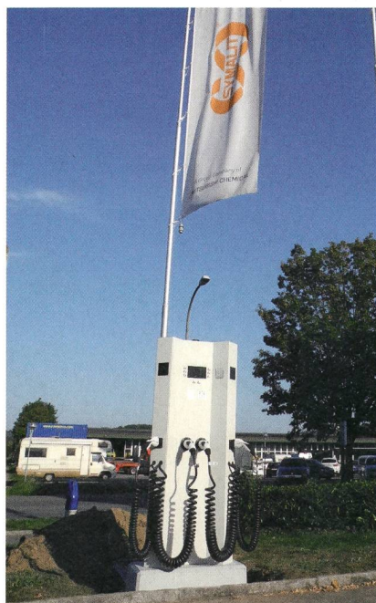
Einsatzbereite Elektro-Tanksäule bei der Symalit AG.
