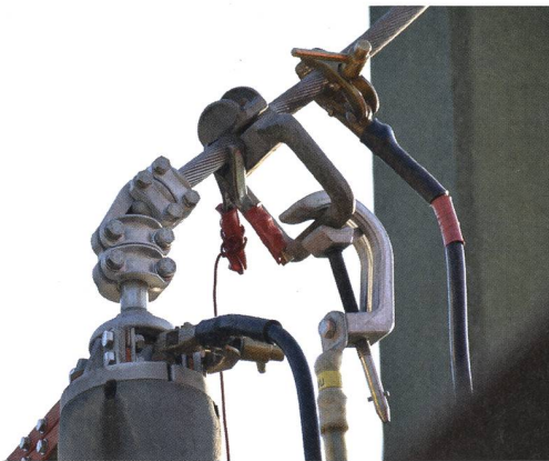
Die Messung des Übergangswiderstands zeigt, dass die additiv gefertigte Abgangsklemme genau gleich wie konventionell gefertigte Klemmen eingesetzt werden kann.
