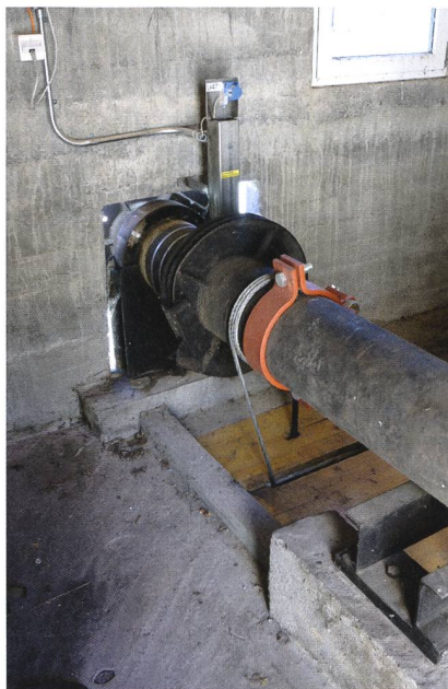
Ein Stahlseil betätigt die Antriebsachse der Stauklappe.
