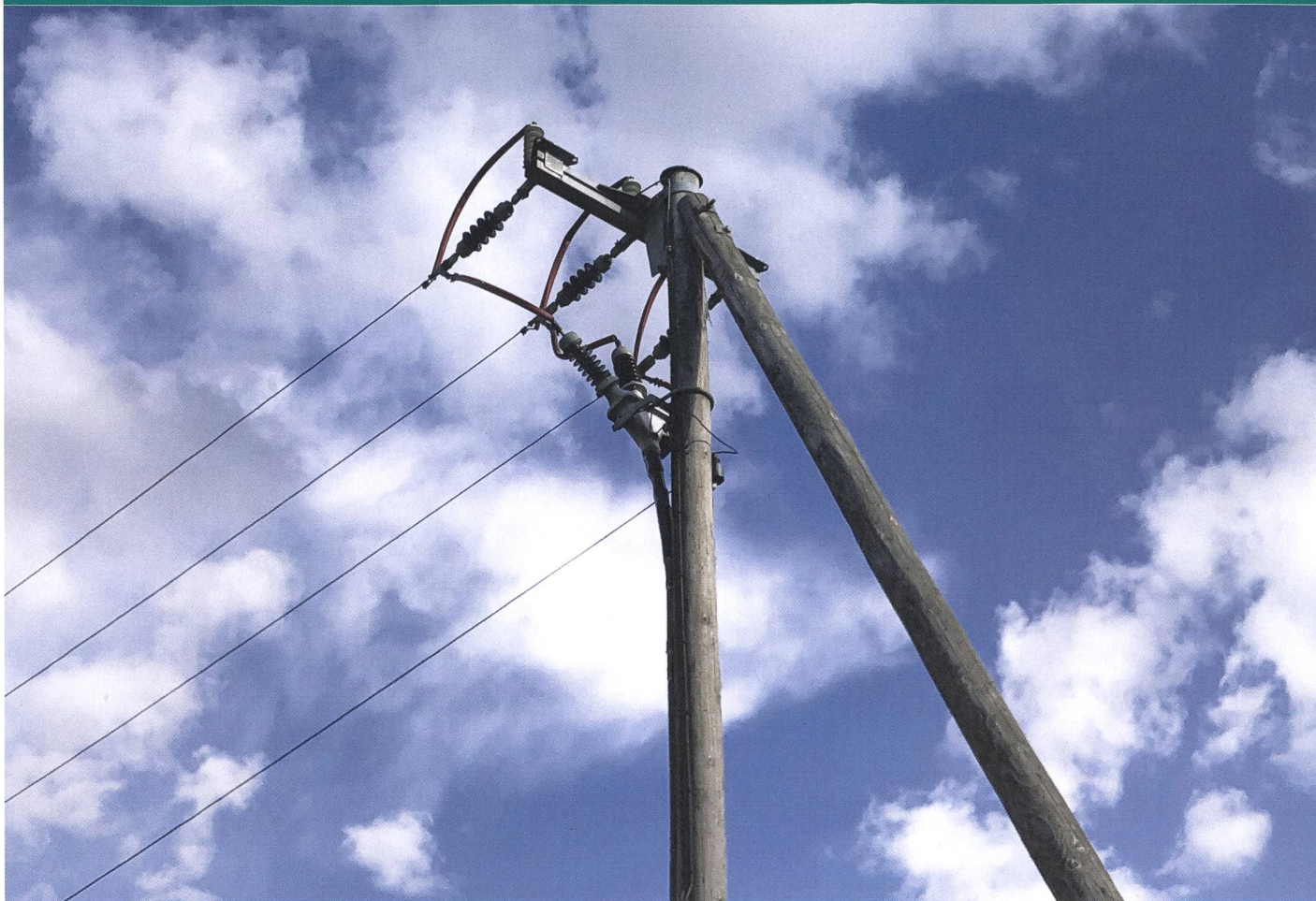
Ein Strommast vor La Punt Chamues-ch mit roter Isolation an den stromführenden Teilen.
