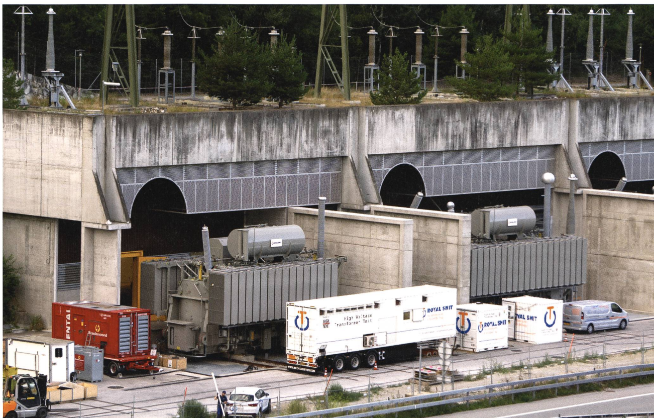
Phasenschieber-Transformator von Swissgrid in Chippis.
