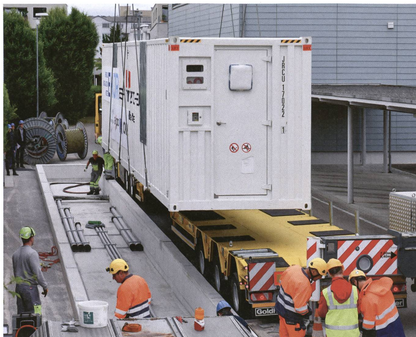
Lieferung der beiden Batteriespeicher-Container auf den Werkhof in Jona.
