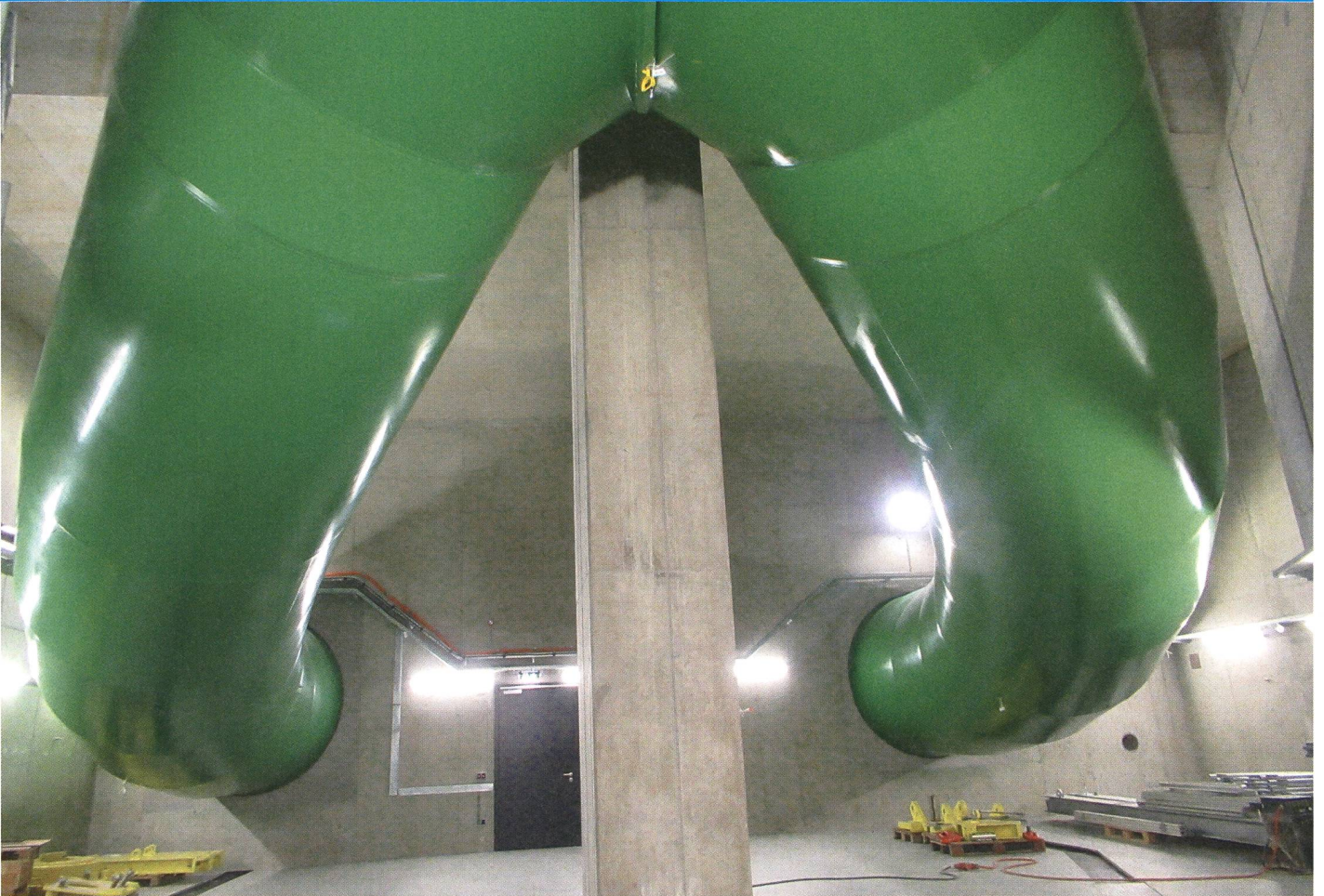
Mit dem Hosenrohr in der Zentrale Prutz wird das Wasser auf die beiden Turbinen geleitet.
