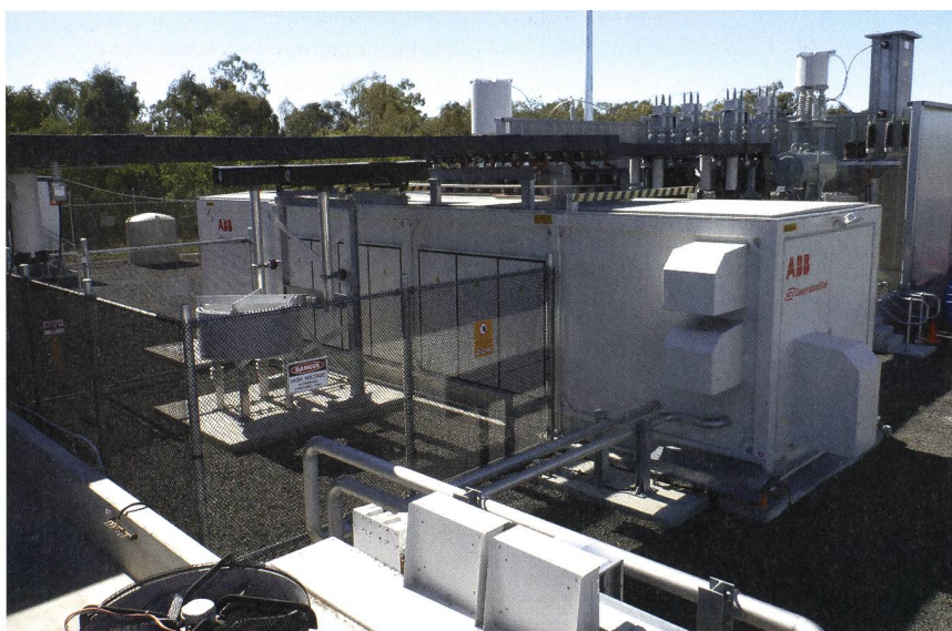
Bild 4 20-MVA-Phasewandler in Wulkuraka (Queensland, AU), an 3 AC 110 kV 50 Hz.
