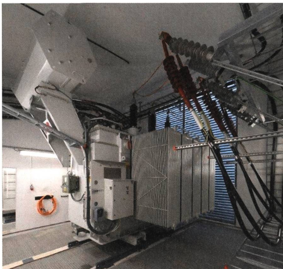
Bild 3 15-MVA-Frequenz- und Phasewandler in Stavanger (NO), an 3 AC 45 kV 50 Hz.
