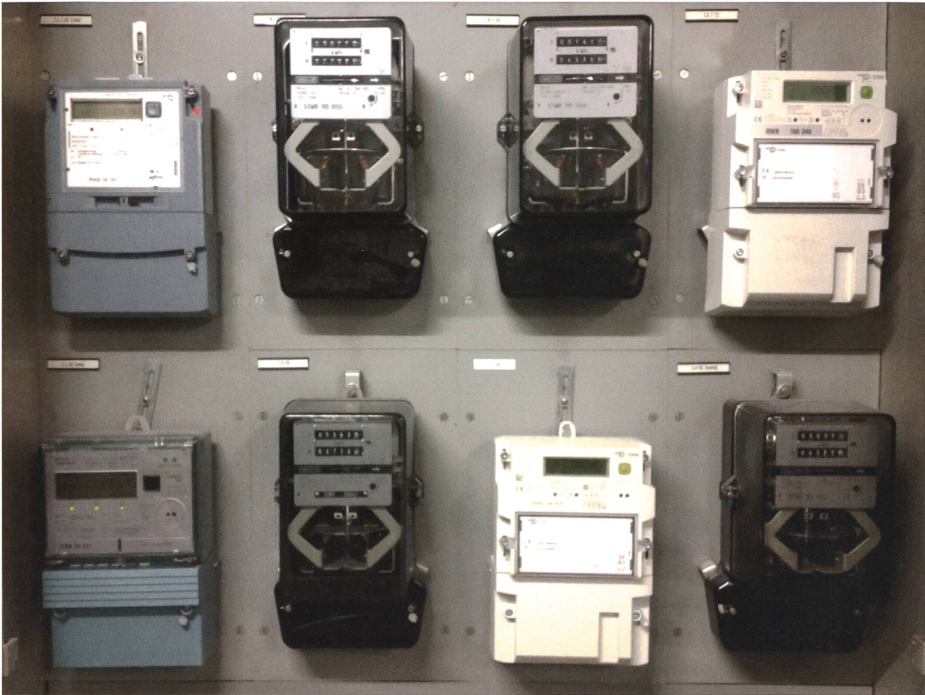
Zählerkasten eines ZEV.
