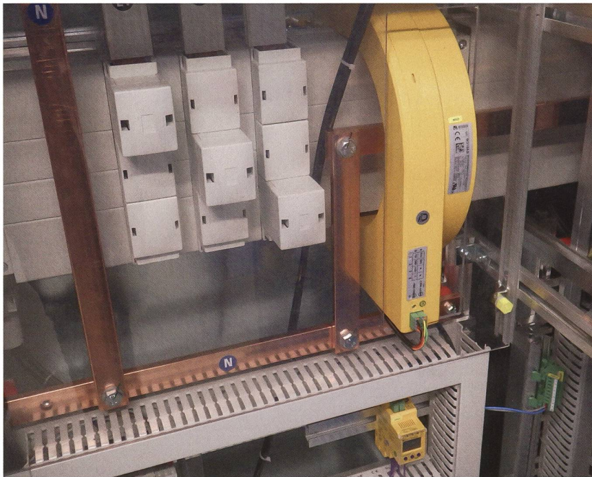
Bild 4 Stromwandler mit Steuergerät einer Differenzstromüberwachungseinrichtung (RCM) in einer NSHV.
