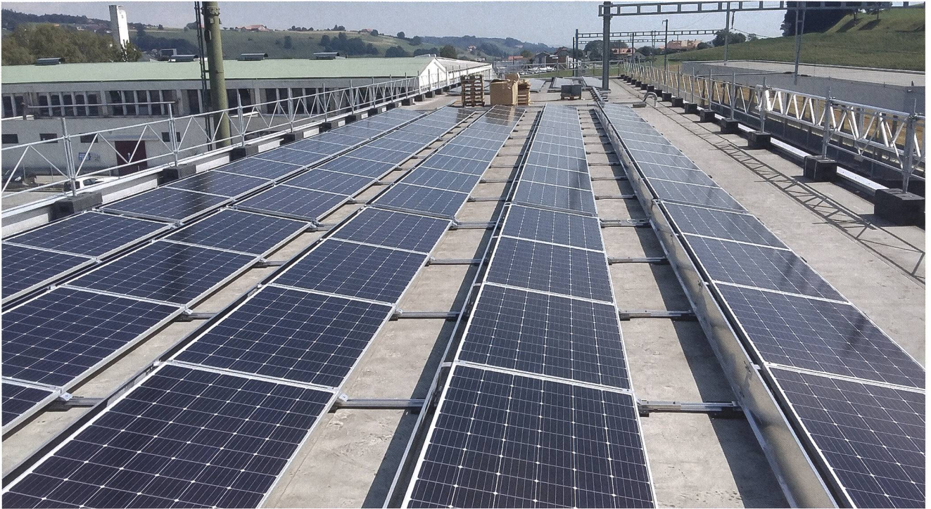
En collaboration avec un contractant, les Transports publics fribourgeois (TPF) ont réalisé des installations photovoltaïques sur les toitures des quais, sur quatre sites jusqu'à présent (sur la figure : la gare de Belfaux). La taille de l'installation PV est adaptée au potentiel de consommation propre de la gare en question. Environ 60 % du courant produit peuvent être consommés directement sur place (dispositifs de sécurité, publicité, distributeurs de billets, ventilation).
