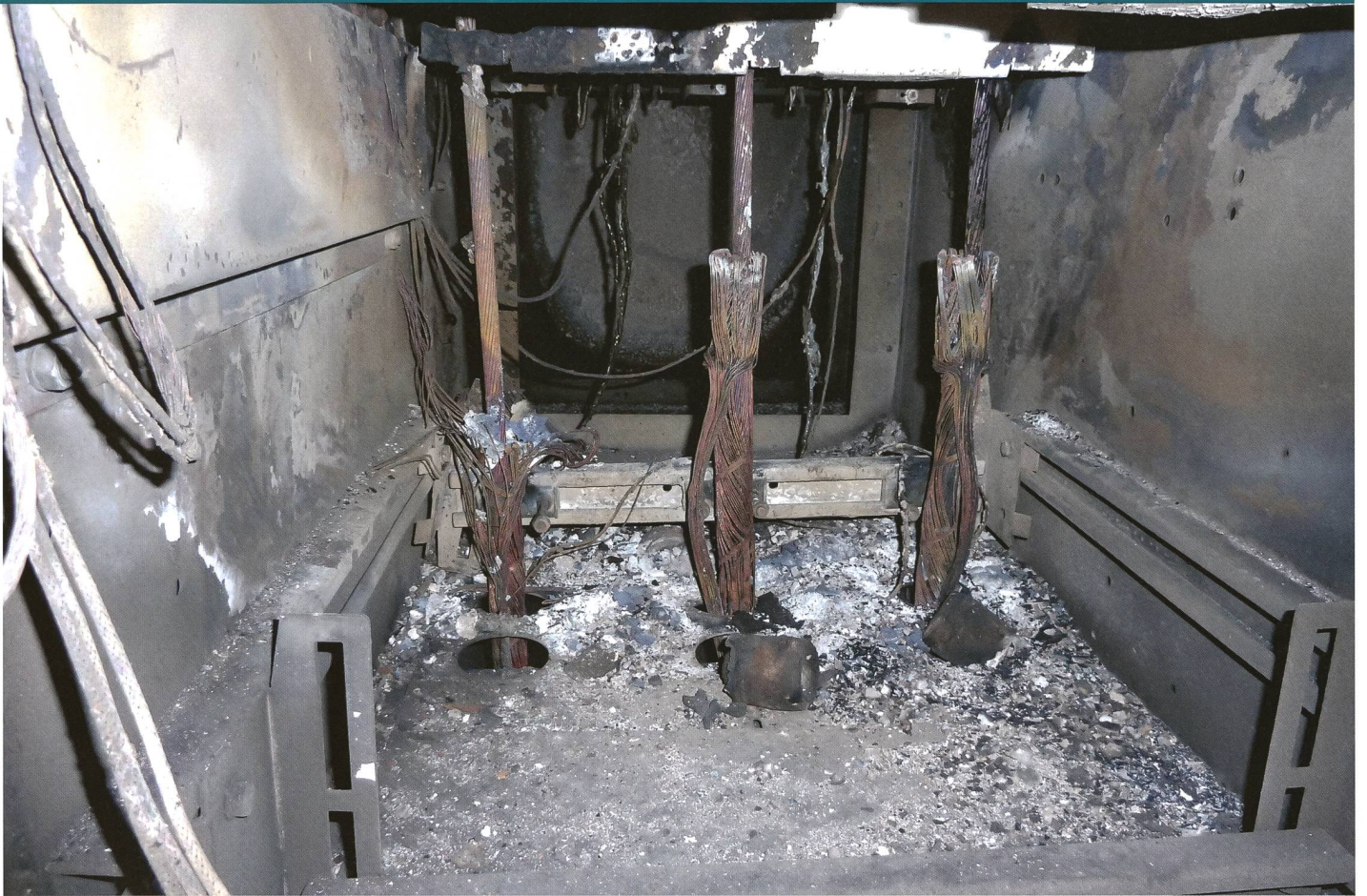
Zerstörte Zelle einer Mittelspannungs- Schaltanlage.
