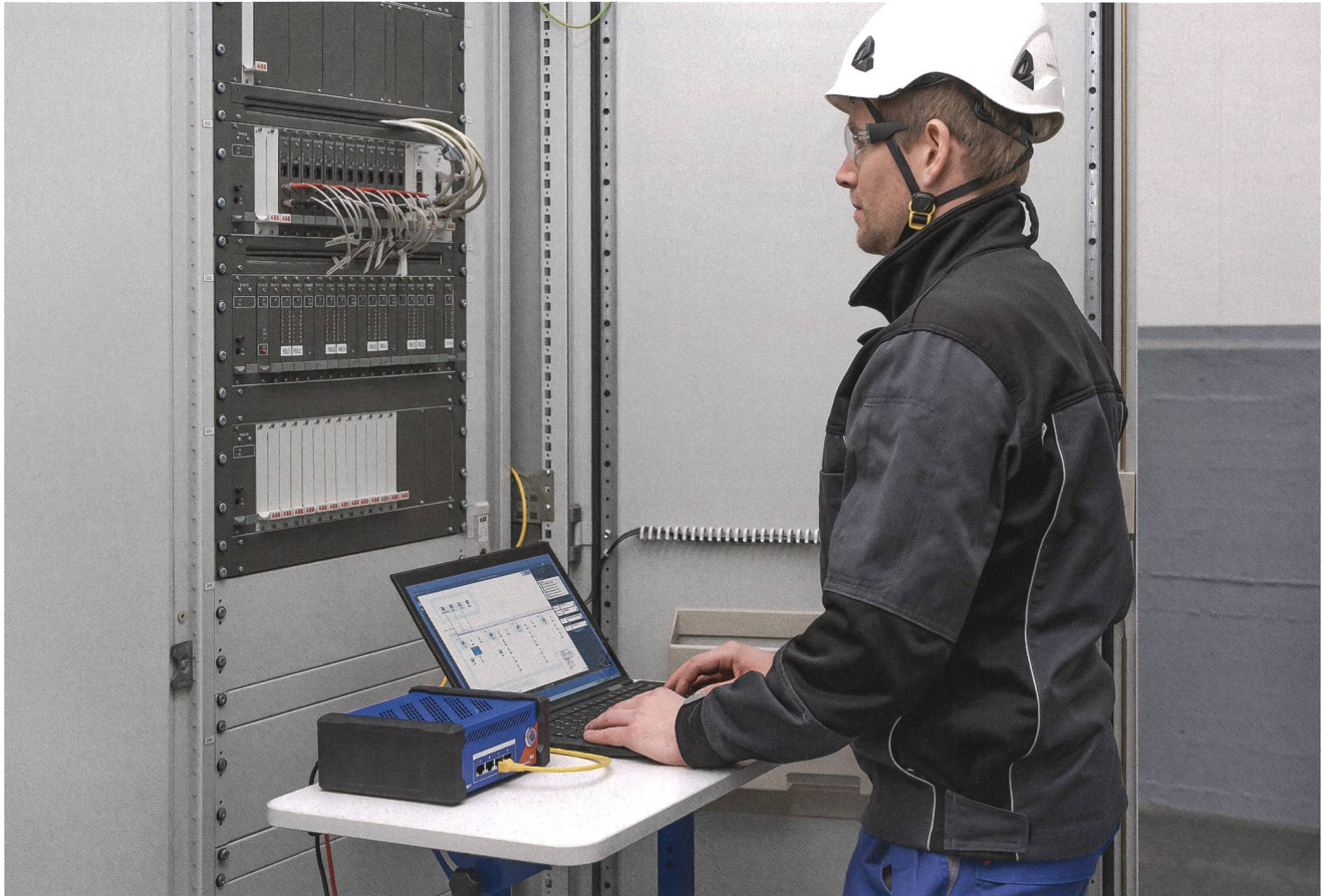
Eine Anlagenprüfung mit StationScout.
