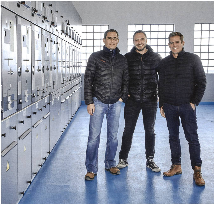
Les ingénieurs de projet Patrick Ducret et Gabriel Pelet, de Romande Energie, et Vincent Hauert, responsable de l'agence Beckhoff d'Yverdon, devant les appareillages à haute tension (de g. à d.).
