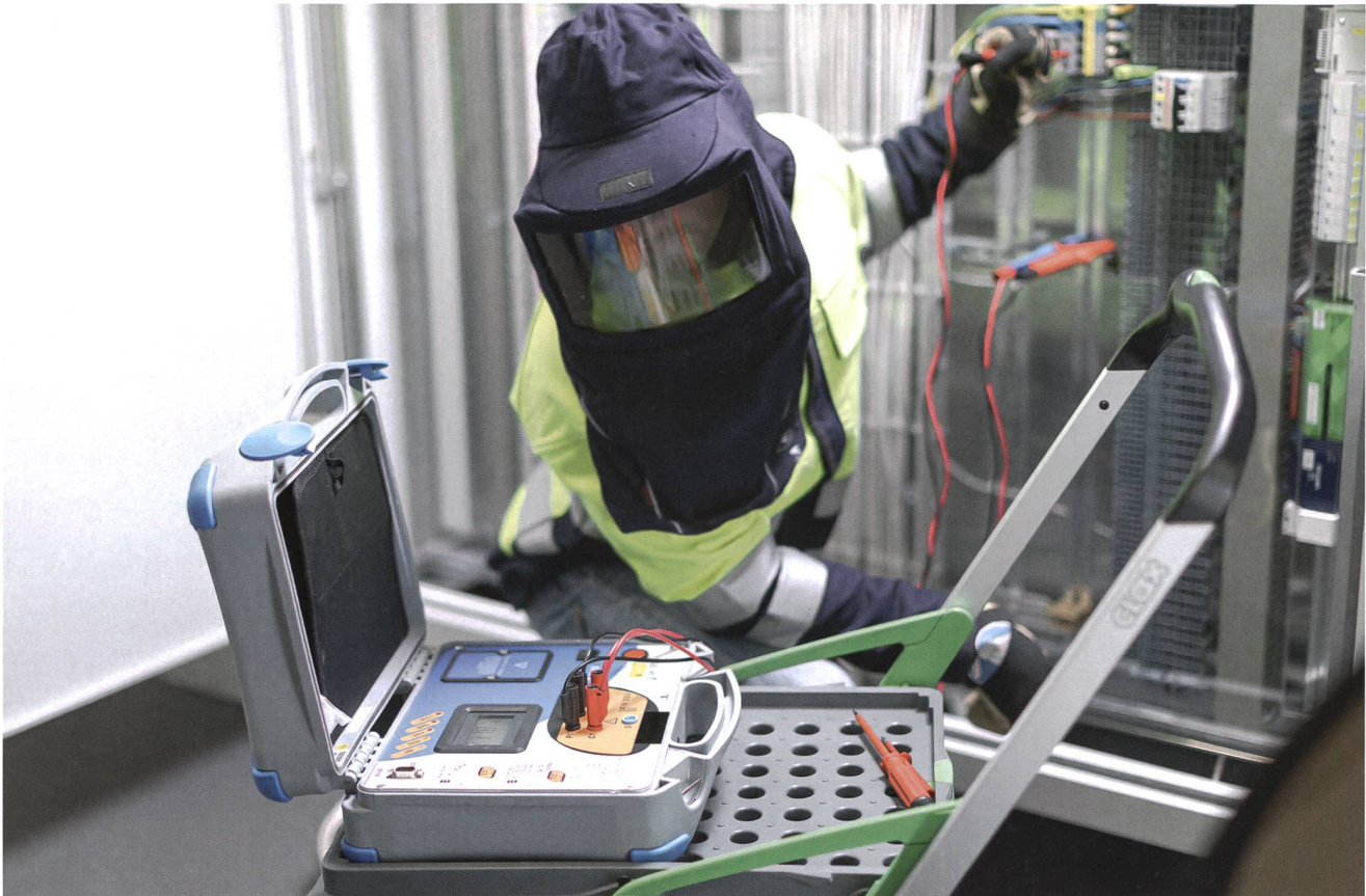
Fachgerechte Kontrolle der elektrischen Installationen.
