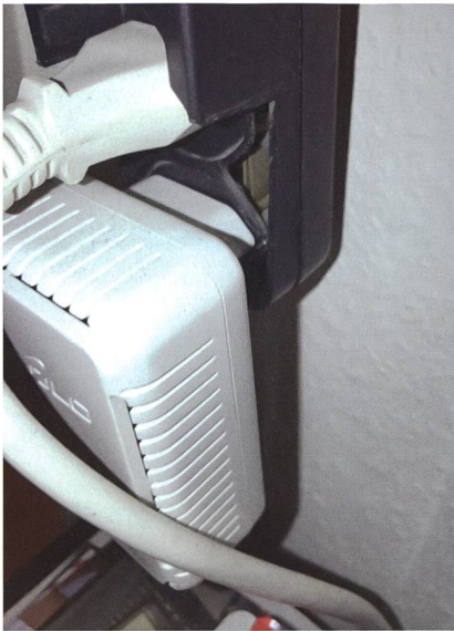
Defekte Steckdosenleiste in einem Kinderzimmer.
