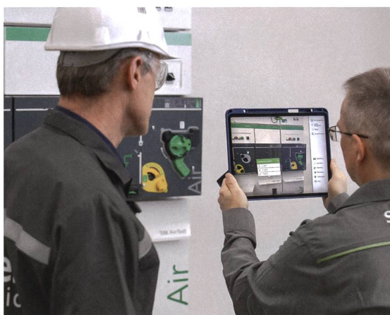
Digitale Überwachung des Gesundheitszustandes von Schaltanlagen.
