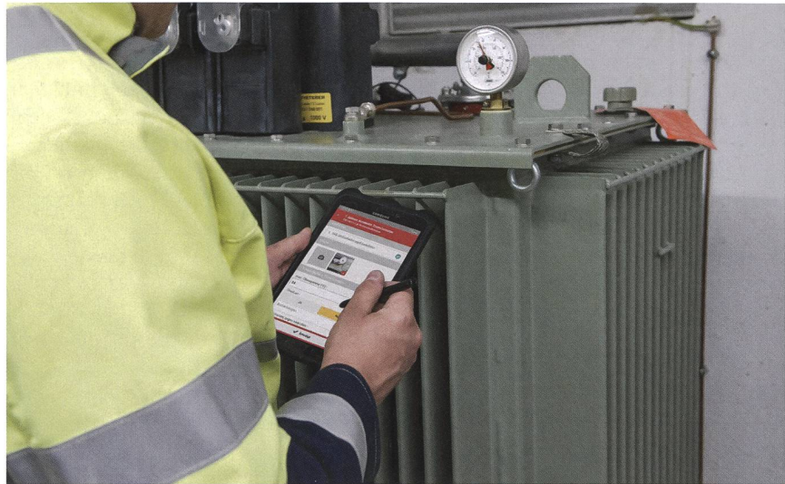
Bei dieser Checkliste sind für häufige Anlagen wie Trafostationen die zugehörigen periodischen Aufgaben, Kontrollen und Meldungen schon vorkonfiguriert.
