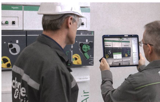
Surveillance digitale de l'état de santé des tableaux de distribution.
