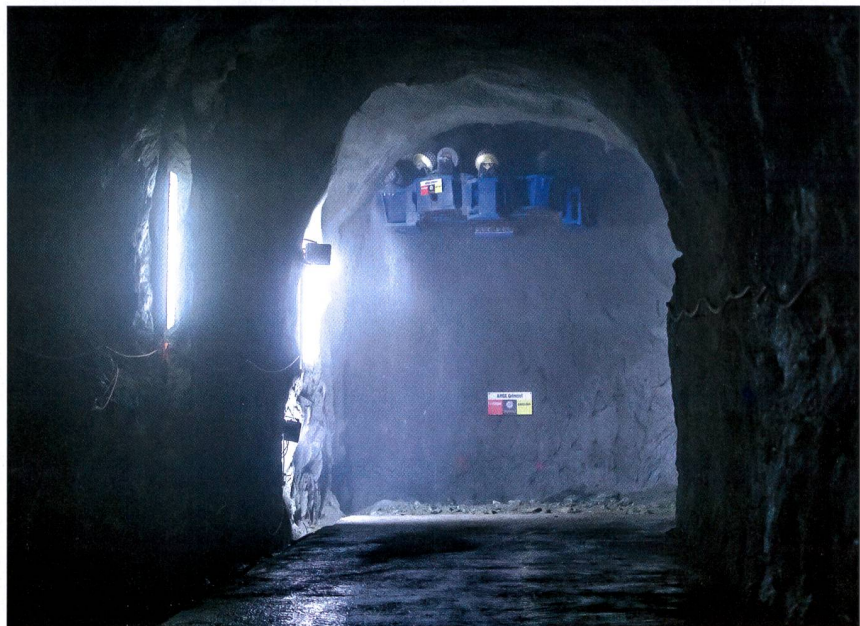
La tête de forage est prête pour creuser un puits dans la roche de bas en haut.
