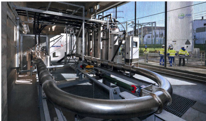
Câble supraconducteur de 10 kV utilisé d'avril 2014 à mars 2021 dans le centre-ville d'Essen. Le réservoir d'azote se trouve à droite, à l'extérieur du bâtiment.
