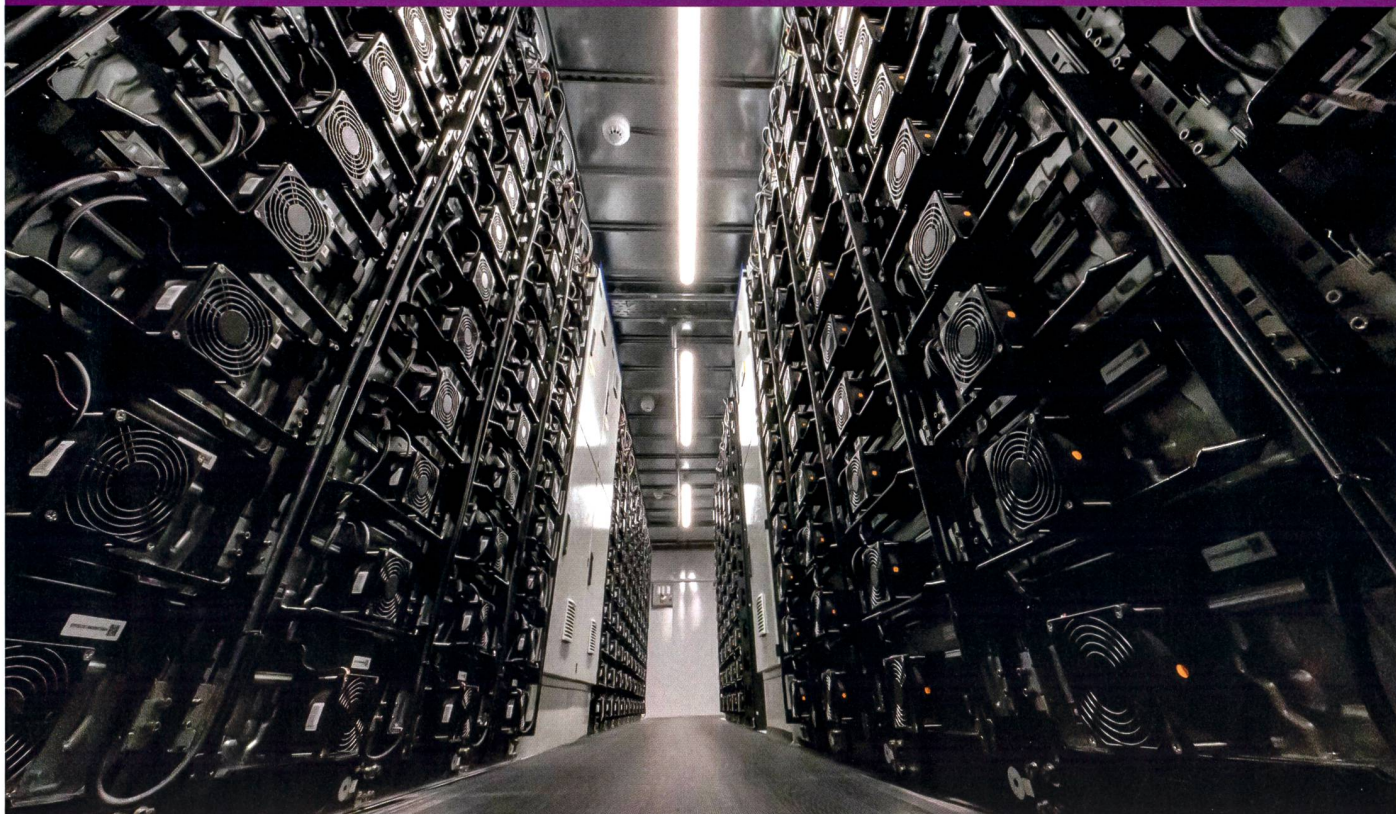
Intérieur du système de stockage d'énergie par batterie installé dans le démonstrateur REel.
