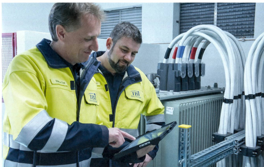
Digitale Prüfung einer Anlage - hier bei Inventsys-Kunde Industrielle Betriebe Interlaken.
