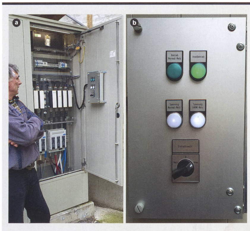
Figure 1 a) Otto Wartmann, à côté de l'installation qui a permis d'étudier l'alimentation électrique de secours au moyen d'énergies renouvelables sur le site de l'exploitation agricole « Holzhof », et b) interrupteur-sectionneur utilisé pour établir un réseau en îlot, en séparant l'alimentation de secours du réseau électrique général.
