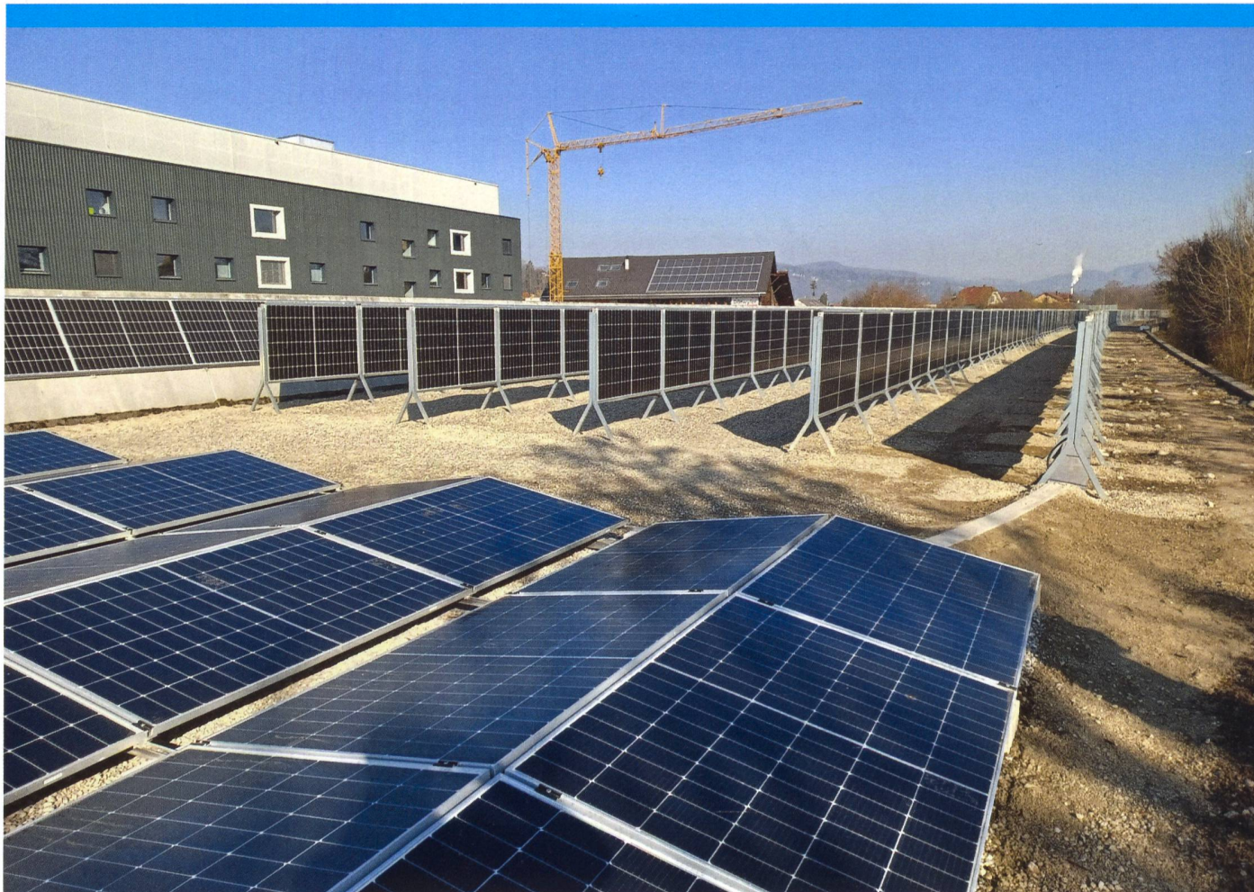
Zofingen: PV-Anlagen mit Lärmschutz und Biodiversität kombiniert.
