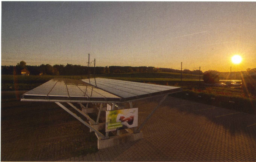
Der Solar-Ladepark in Fehraltorf bei Electrosuisse. Strom wurde ab 2013 generiert, ab Mai 2022 kann dort damit auch geladen werden.
