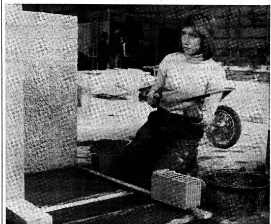
Das erste Maurerlehrlingmädchen im Kanton Zürich, die 19jährige Holga Kuriger aus Lachen SZ, hat zusammen mit 199 männlichen Kollegen in Ebnatingen ihre Abschlussprüfung absolviert; ihr Ziel ist, später Bauführerin zu werden. (P)
