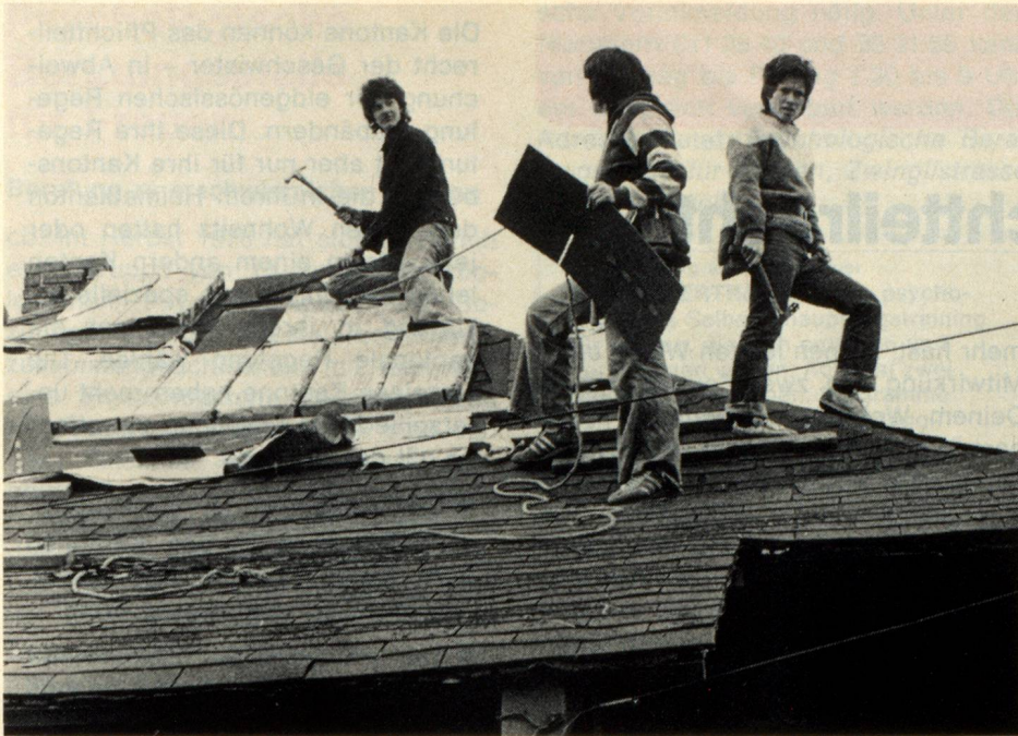
«Seven Sisters Construction Company» nennt sich eine Baufirma in San Francisco, die im Zeichen der Frauenbefreiungsbewegung gegründet wurde. Unser Bild: drei Mitglieder der weiblichen Baufirma beim Dachdecken.
