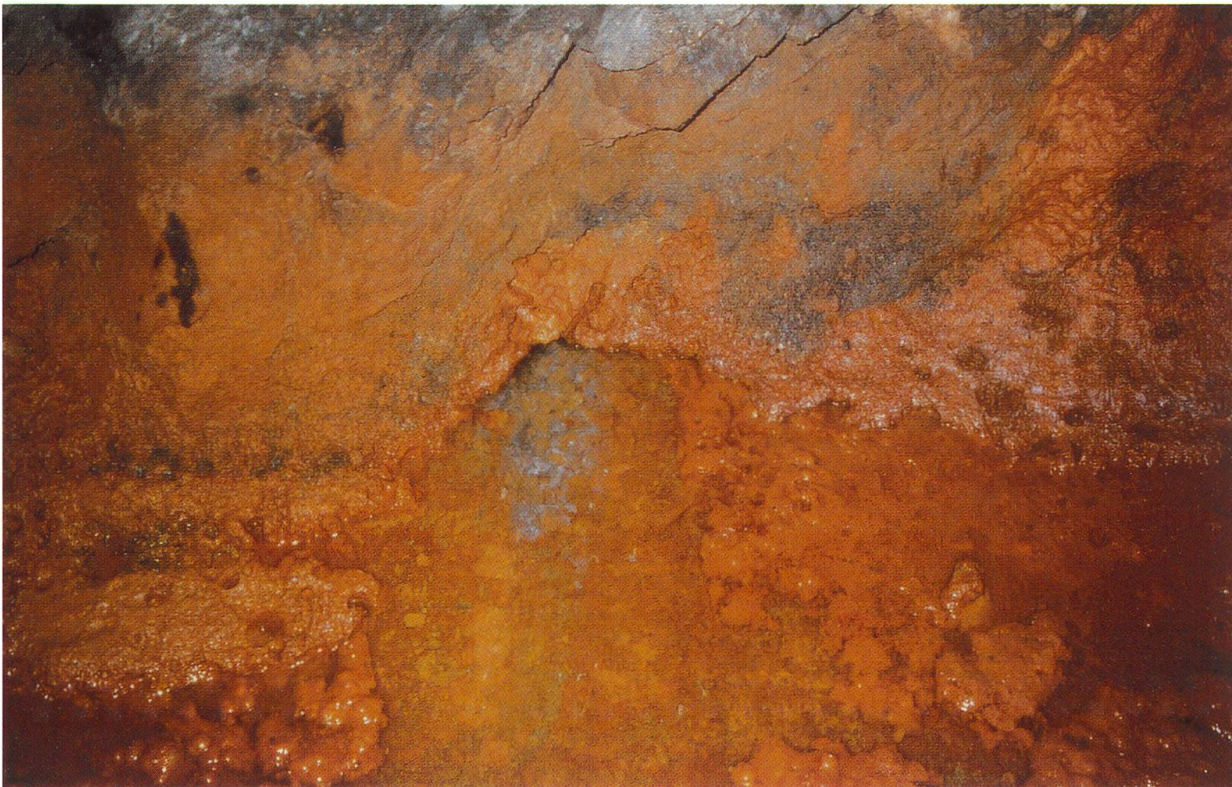
Abbildung 10: Wasseraufstoss im Montperjörisstollen (Typ ‹Tiefenwasser›). Die Breite des Bildausschnittes beträgt ca. 0,6 m.
