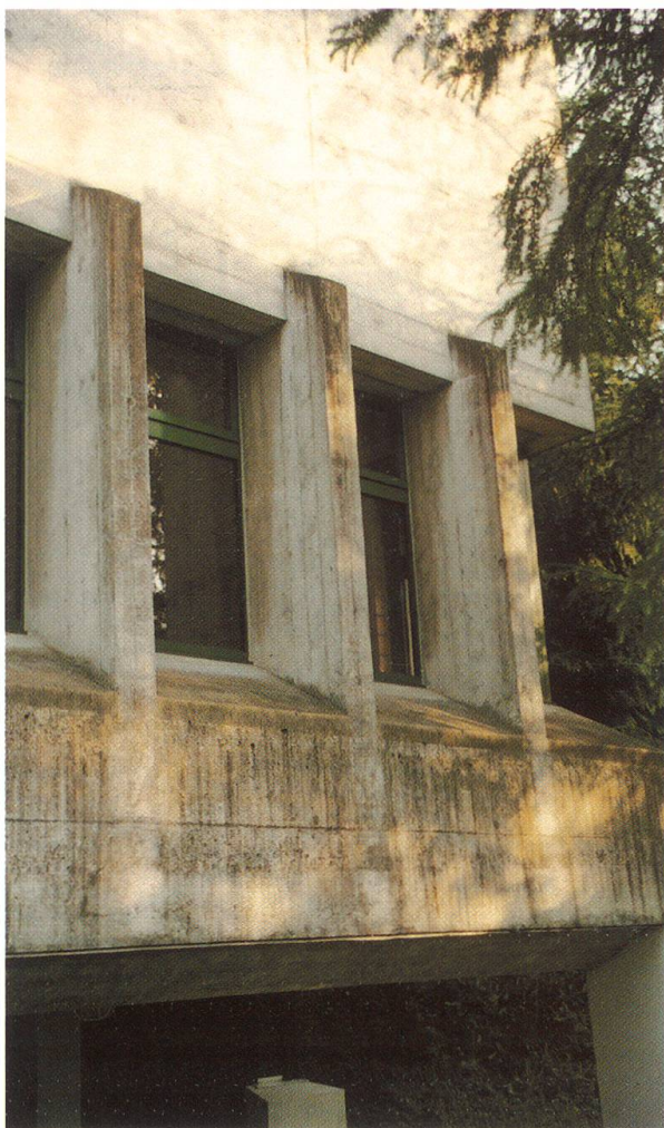
Abbildung 7: Bewuchs der gleichen Turnhalle 12 Jahre später.
