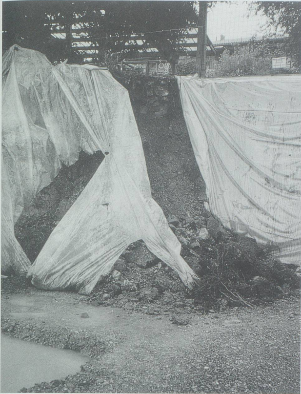
Jona, Kempraten, Fluhstrasse 8/10. Schlecht gesichert: abgestürzte römische Mauer. (Bild KASG)
