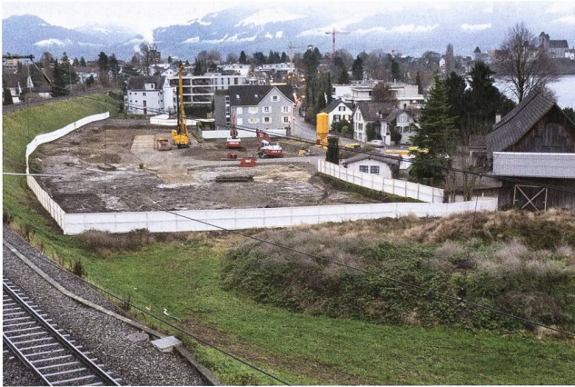
Rapperswil-Jona, Kempraten, Seewiese. Nach dem Start der Bauarbeiten im Dezember. Aufnahme KASG.
