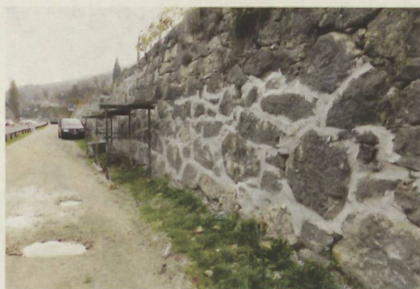
Halbseitig ist die Sanierung der Trockenmauer an der Neuenburgstrasse. Nun geht es aber vorerst nicht weiter.
